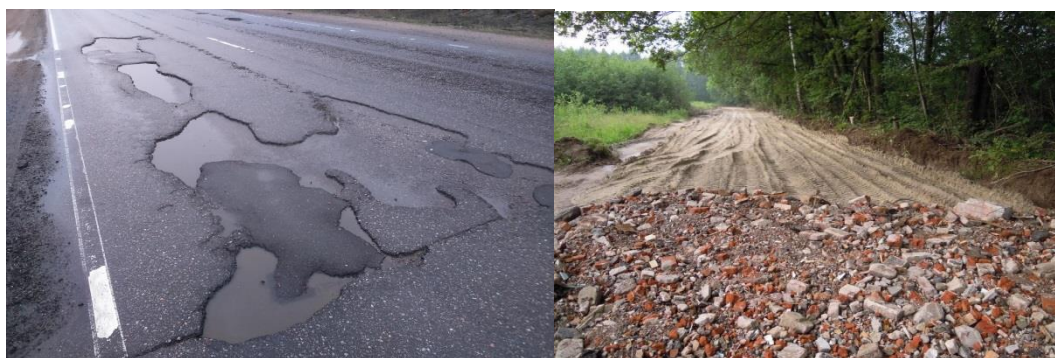
Рис. 3 Участок с плохими дорожными условиями [3]
